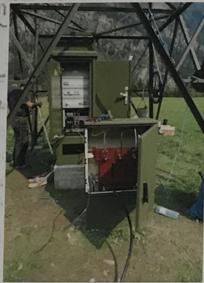
Stromversorgung 400V AC mit Trenntransformator
