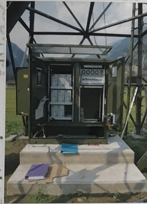
Station mit Akkus und DC- Stromversorgung
