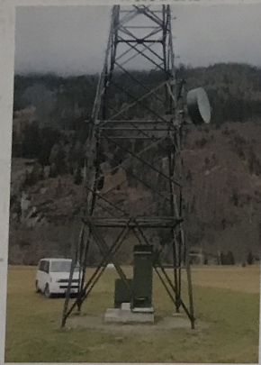
Gesamtansicht Station Mast 041
