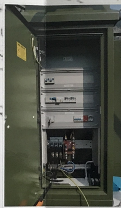
400V AC Stromverteilung
